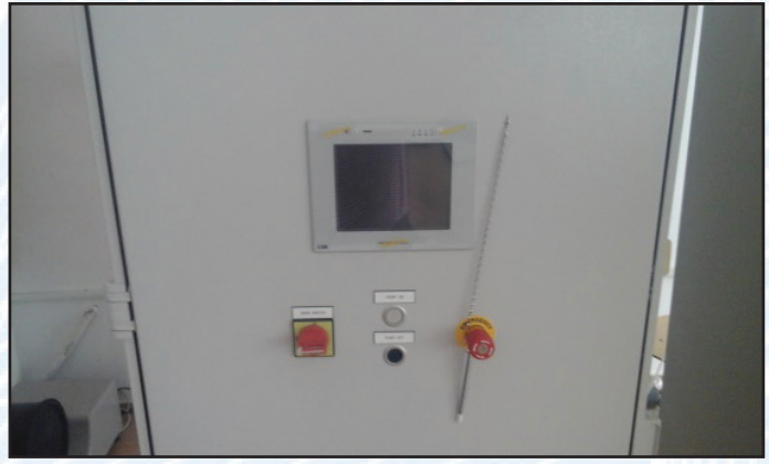
Fig. 58. b. Panou PLC
