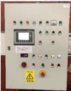
Fig. 29. Panou comanda - sistem modular pentru controlul automat al procesului de vopsire sub presiune a firelor textile din lana si tip lana
